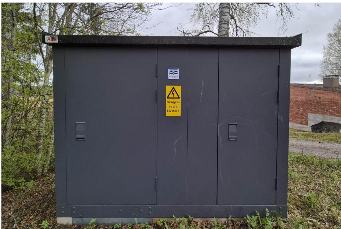
Kuva 15.2. Asianmukaisesti toteutettu puistomuuntamo Linnamäen pohjavesialueella. Muuntamo on myös merkitty pohjavesialueesta muistuttavalla merkinnällä. Kuva: Riikka Mäyränpää.
